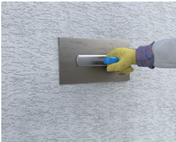
Abb. 10.26: Einlagiger Leichtputz als Außenputz auf Porenbetonmauerwerk – Aufbringen der zweiten Schicht und Strukturieren der Oberfläche
